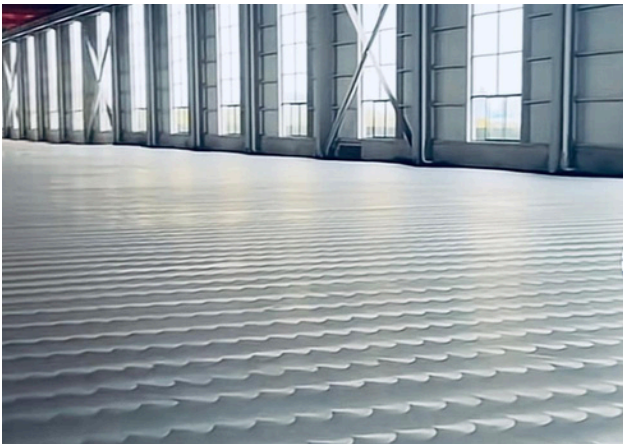
Bild 1: Industrieböden aus Beton mit Staplerverkehr
